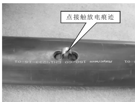
图9 均压环连接母排的弹簧与母排接触处放电痕迹且偏向一侧
