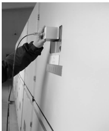
图2 开关柜的外部
