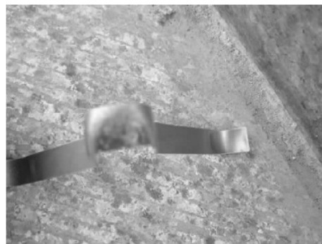
图10 放电痕迹更加严重的均压环弹簧
